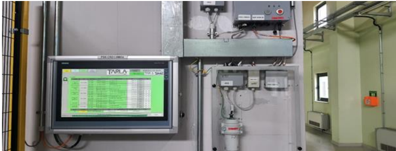
C blok: İç Bina: Radyasyon takip ve güvenlik sistemleri
