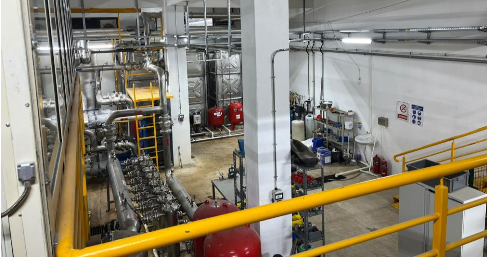
D Blok: Merkezi su soğutma sistemi
