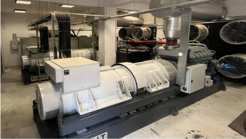
G Blok: UPS Sistemi
